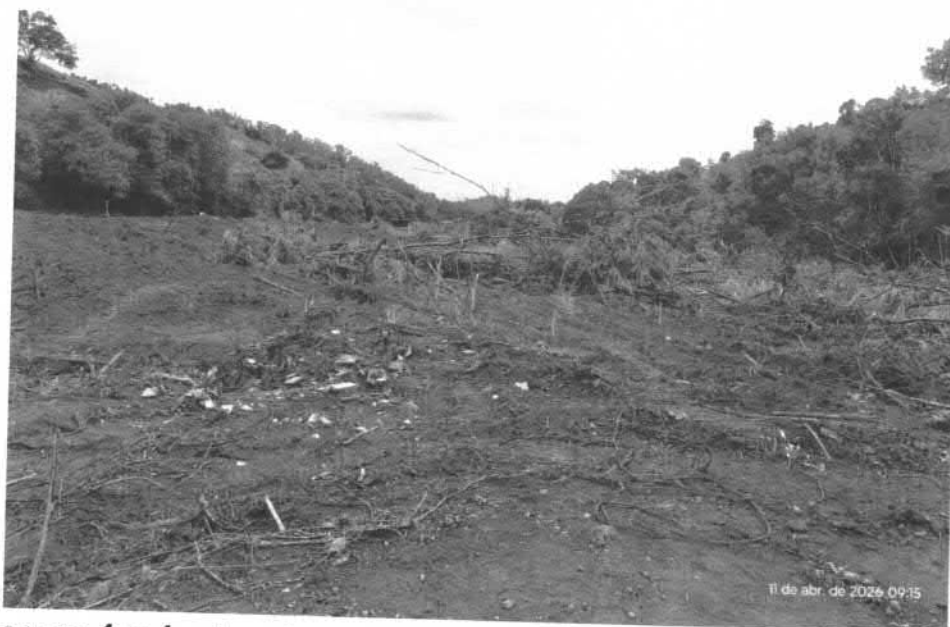
Imagem 1 a 4 – Local onde ocorreu a intervenção em APP com indícios de descumprimento de condicionante e execução e desacordo com o licenciado.
